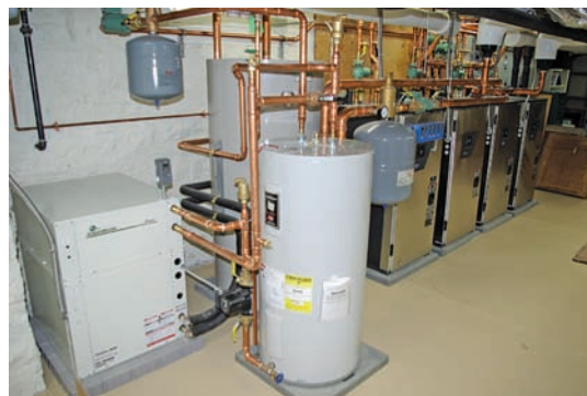
Ilustração 6 - Tubulação de cobre para sistema geotérmico (Sigman Heating and Air Conditioning, Belleville, USA)
